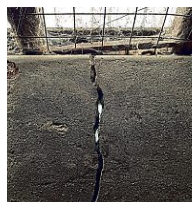
Riss in einem Haus in Groningen
