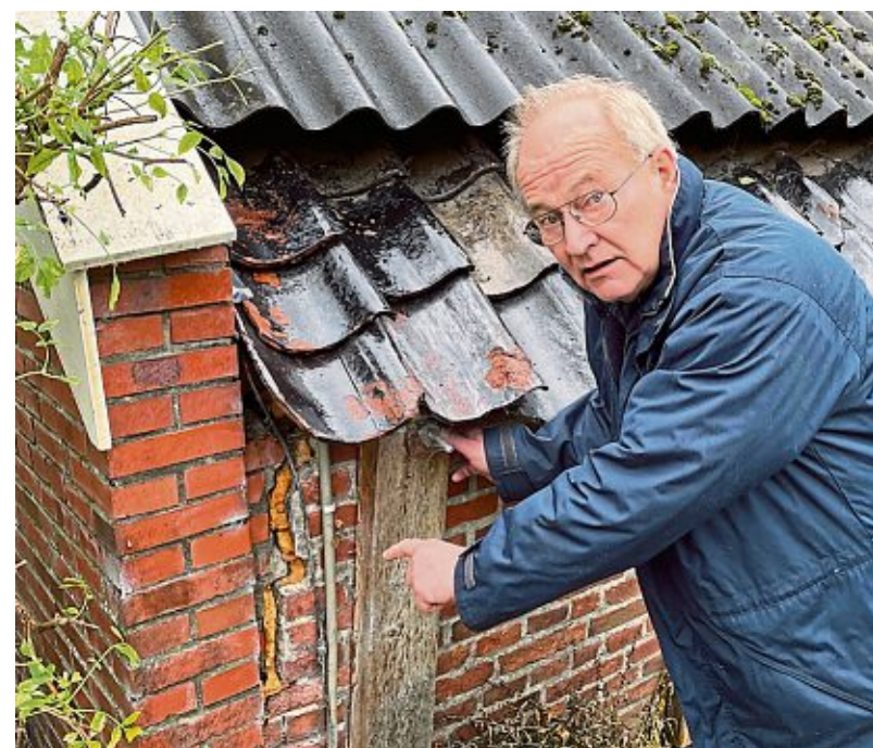
Jan Wigboldus zeigt die Schäden an seinem Hof.
